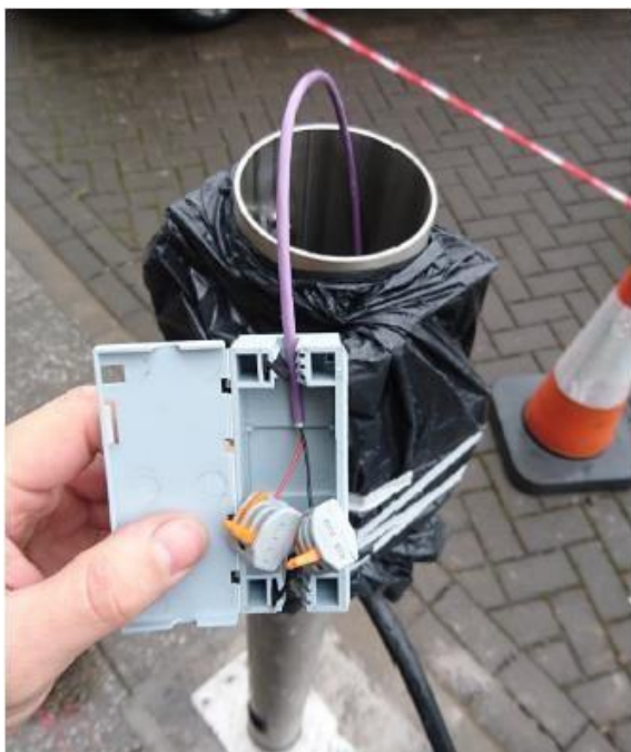
Obrázek 2 – Konektory Wago spojující sériovou sběrnici
